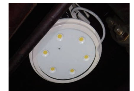
某製鉄所内（電源が置けない場所）
